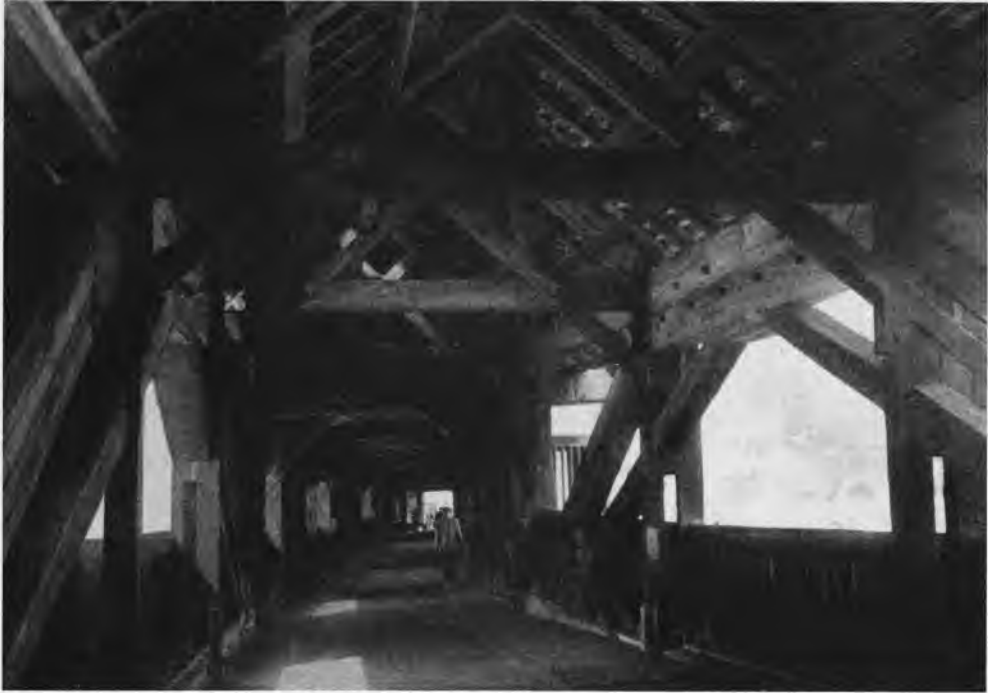
Abb. 9 Rechts die Streben des Hängewerks, dazwischen die Brustriegel und darüber der Obergurt. Hier fehlen die Windversteifungen zwischen den Obergurten
